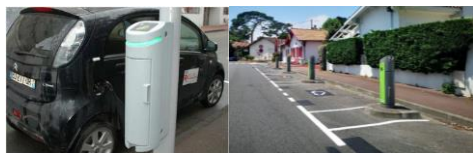
Point de charge sur candélabre, Roche-sur-Yon (source : ADEME, 2019) ; Dispositif IRVE à Arcachon (source : Explain)
